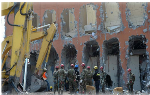
Fotografía N° 4: Limpieza de calles de la localidad de Constitución, producto del terremoto de 2010.
