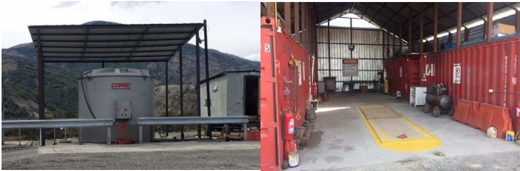
Fotografía N° 34: Tanque de combustible certificado. Fotografía N° 35: Control a taller de mantenimiento.
